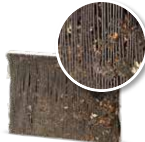
Sin mantenimiento de la climatización
