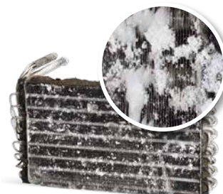
Climatizzatore non sottoposto a manutenzione
