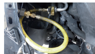
Figure 2 : Les bouteilles déshydratantes/accumulateurs doivent être pontés et remplacés pour le rinçage
