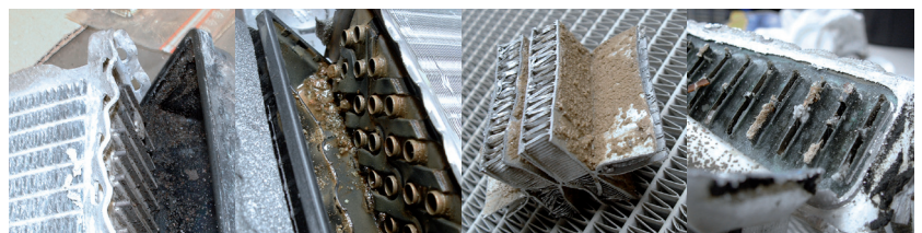
Abbildung 2: Ablagerungen wie Rost, Kalk, Dichtmittel oder andere Fremdkörper sorgen für Blockaden und reduzieren die Kühlleistung
