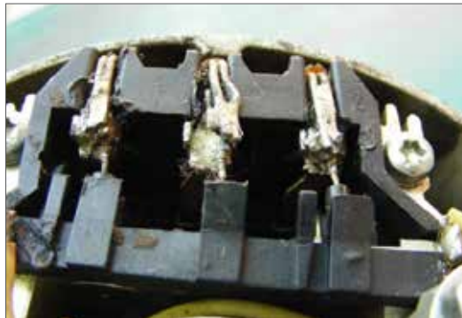
Fig. 4.02 – Solda danificada ou inexistente nos terminais da ponte retificadora.
