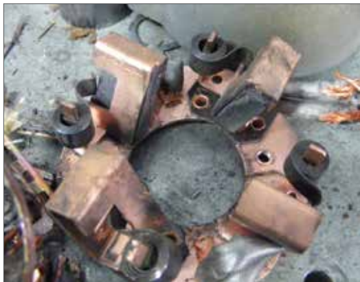
Fig. 3.04 – Possível destruição do porta escovas.
