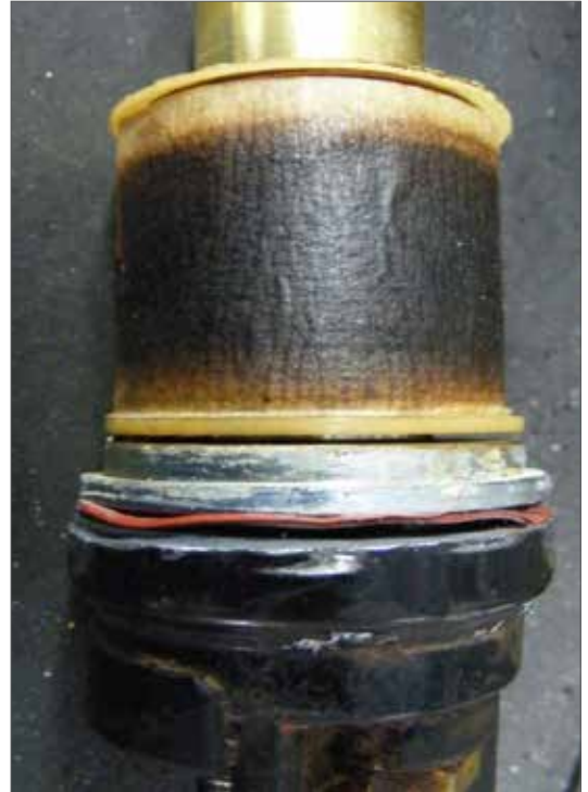
Fig. 3.05 – Queima da bobina interna do solenóide.
