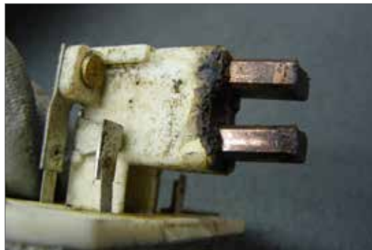
Fig. 3.03 – Queima das escovas e terminais do regulador de tensão.
