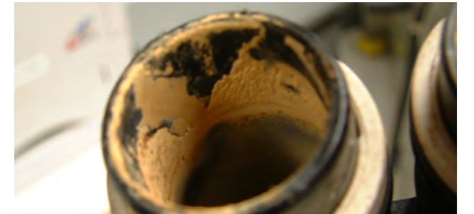
Resim 3 Soğutma sıvısı devresinde korozyon ve birikintiler
