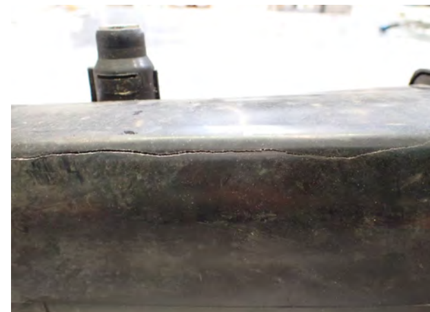
Resim 1 Genleşme haznesinde çatlak
