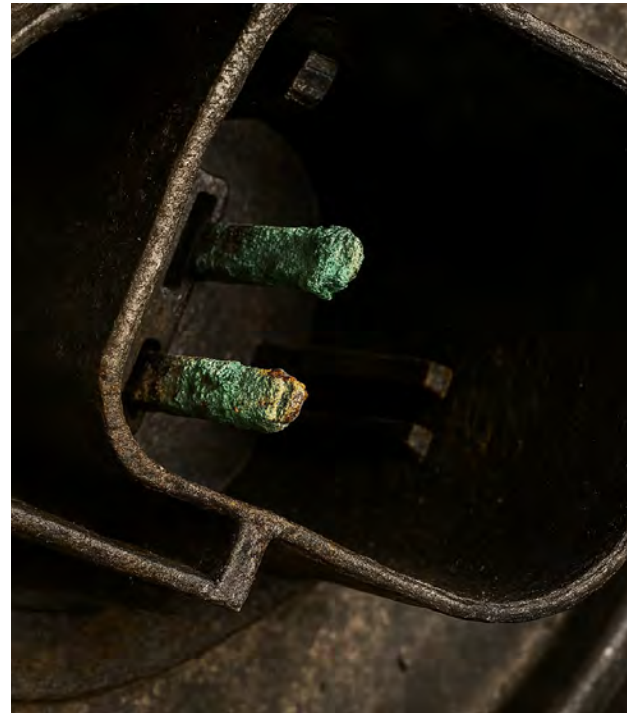
Resim 2 Soket bağlantısında korozyon
