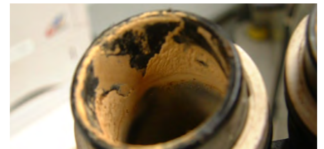
Rys. 3 Korozja i osady w obiegu chłodziwa
