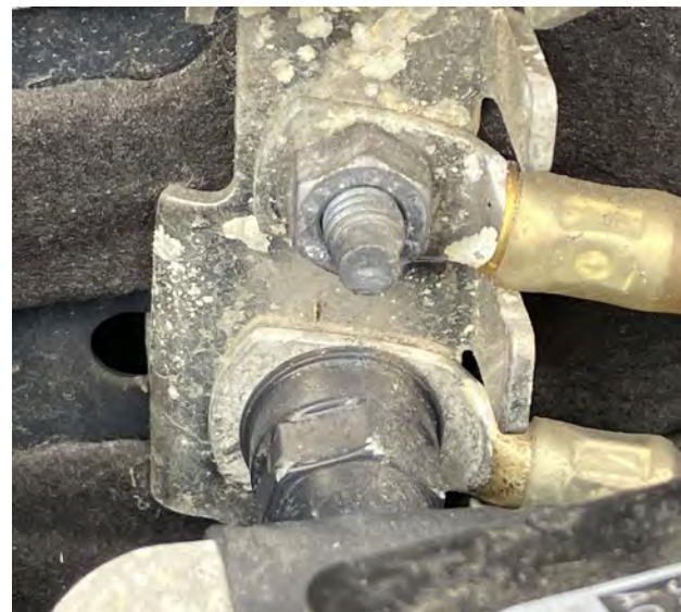
Rys. 2 Korozja w punkcie uziemienia
