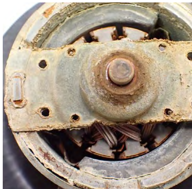
Rys. 1 Uszkodzenie łożyska silnika wentylatora
