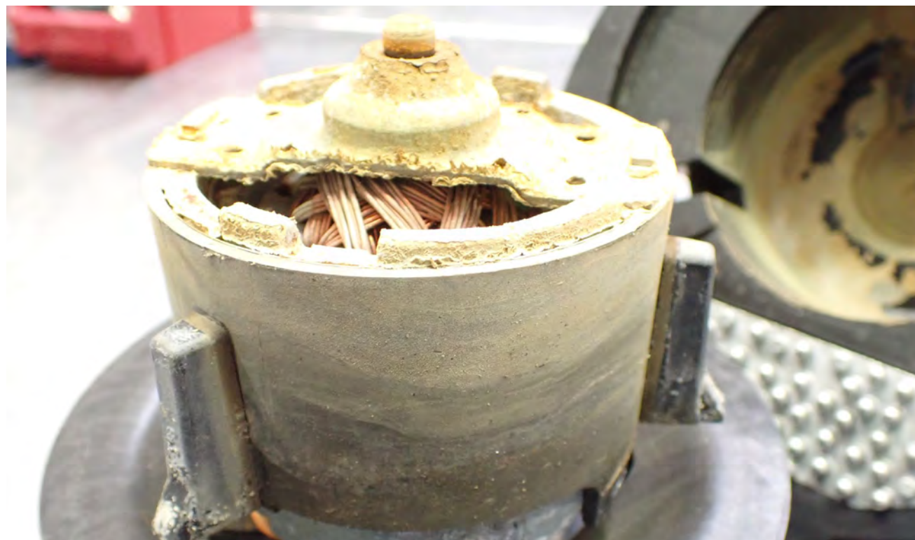
Rys. 4 Korozja na silniku dmuchawy
