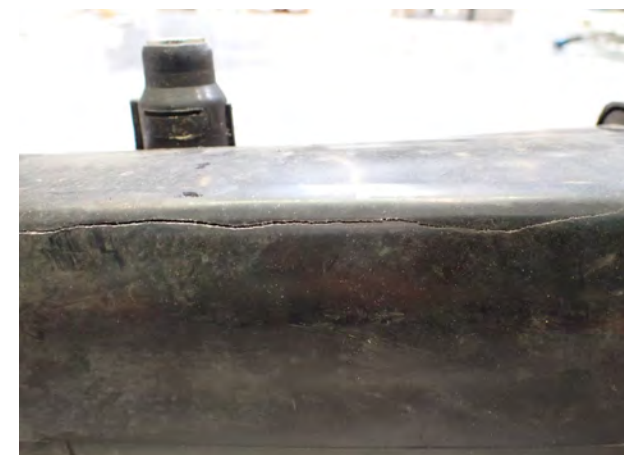
Rys. 1 Pęknięcie w zbiorniku wyrównawczym
