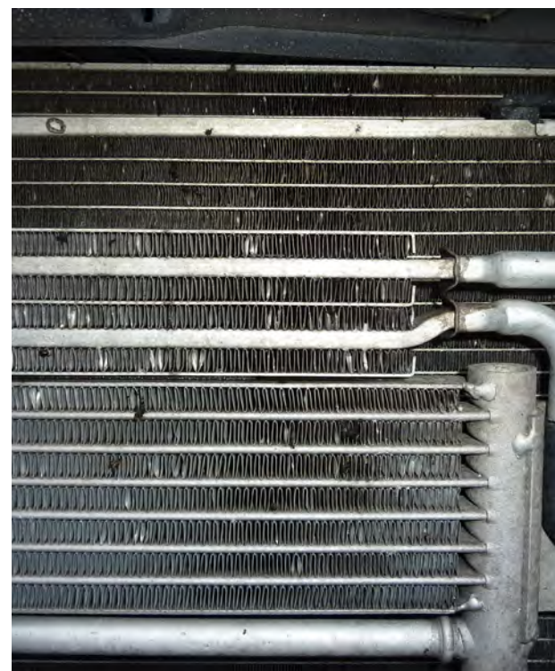
Rys. 1 Zanieczyszczenie na chłodnicy
