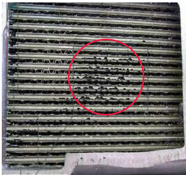
Fig. 1 Cavitation sur les tuyaux du refroidisseur d'huile
