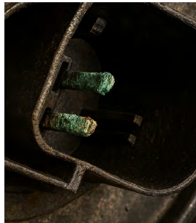
Fig. 2 Corrosion sur les connecteurs
