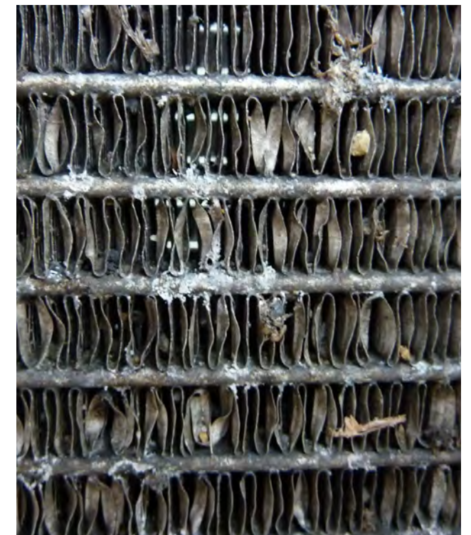
Fig. 2 Impurezas y aletas del radiador deformadas
