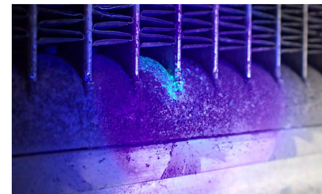
Abb. 2 Durchrostung am Kondensator
