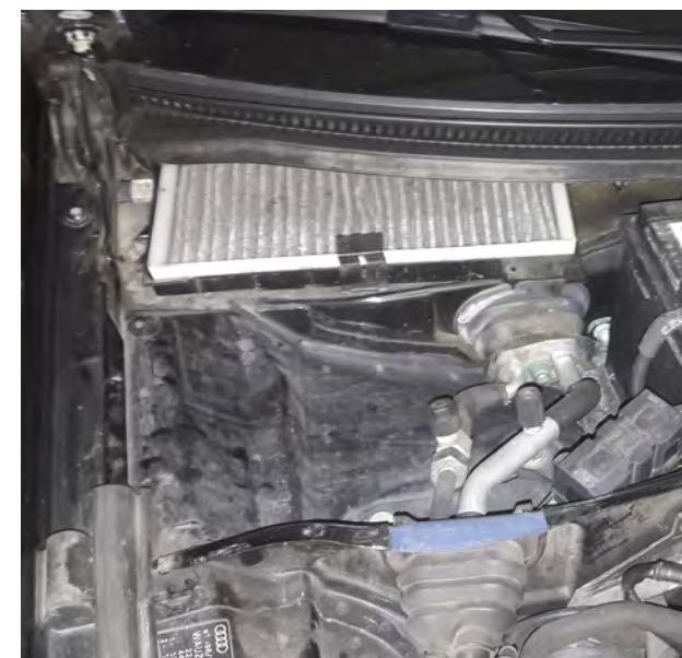
Abb. 1 Stark verschmutzter Innenraumfilter
