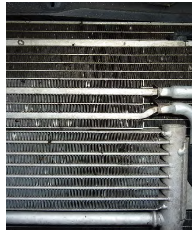
Abb. 1 Verunreinigung am Kühler
