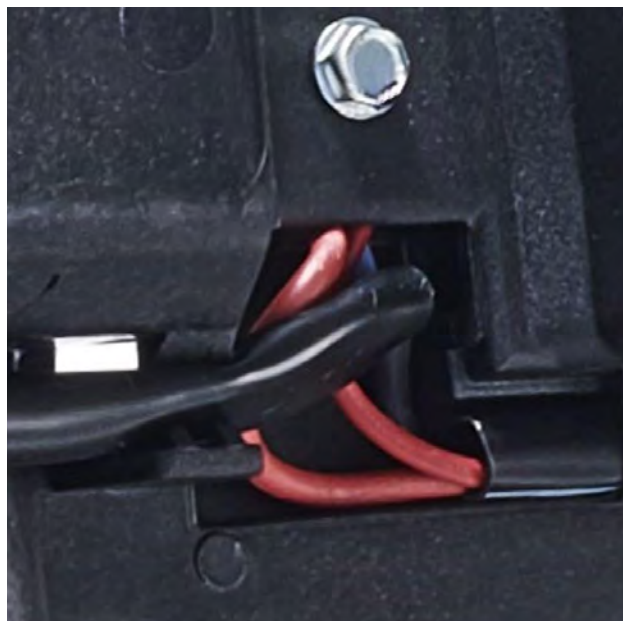
Rys. 2 Pęknięcie kabla na sterowniku wentylatora
