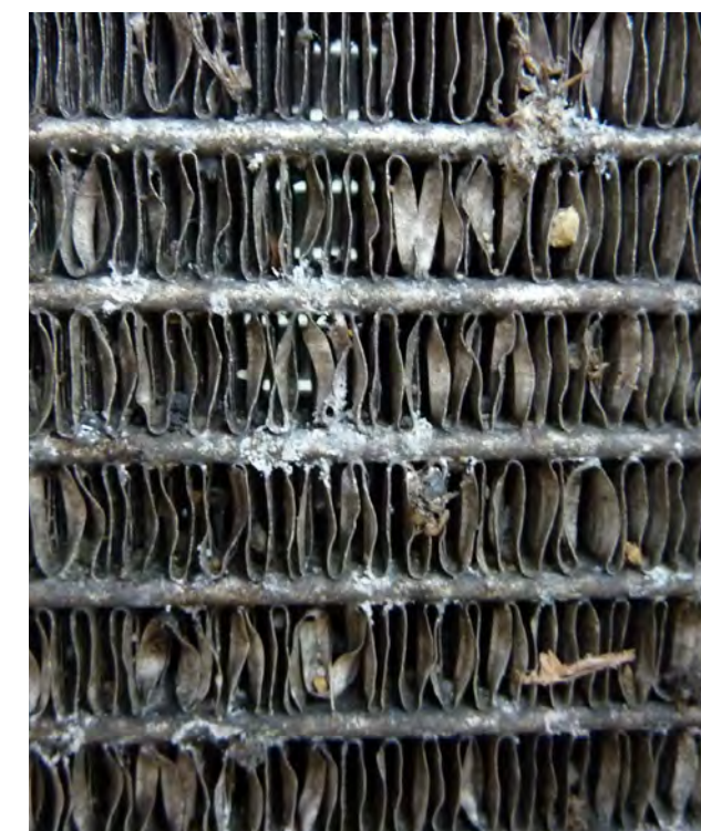
Rys. 2 Zanieczyszczenie na żeberkach chłodzących i deformacja żeber
