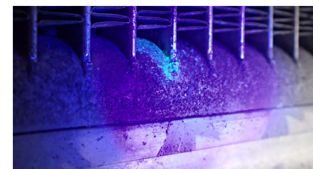
Rys. 2 Korozja na skraplaczu
