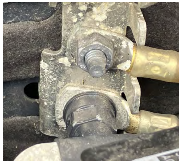
Rys. 2 Korozja w punkcie uziemienia
