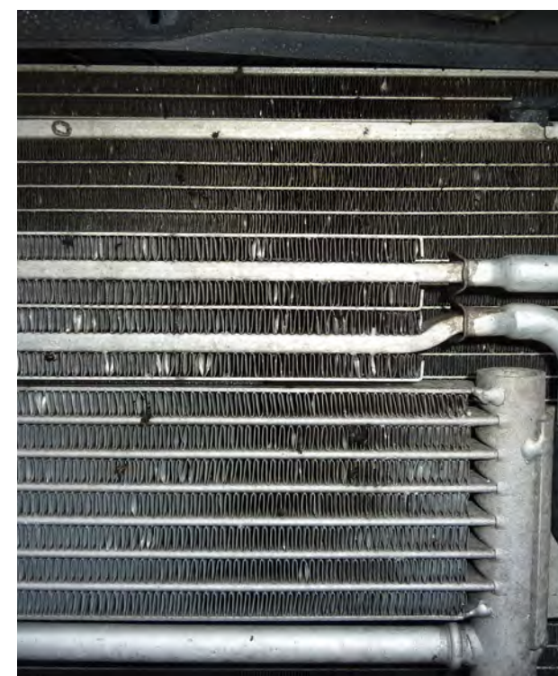
Rys. 1 Zanieczyszczenie na chłodnicy
