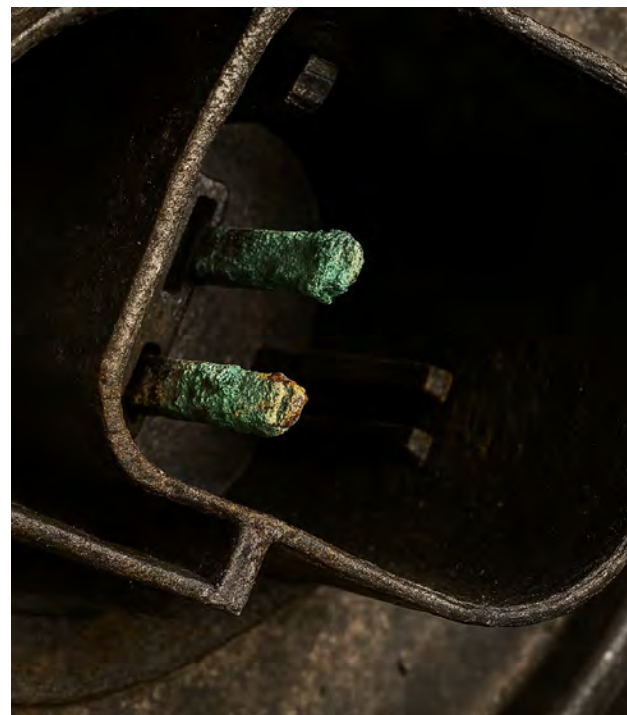
Rys. 2 Korozja połączenia wtykowego
