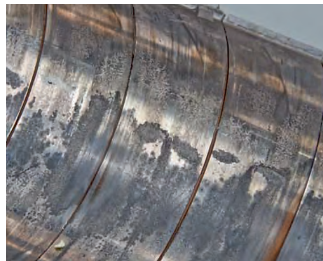
Fig. 1a Couche de frottement corrodée par des substances corrosives dans l'huile
