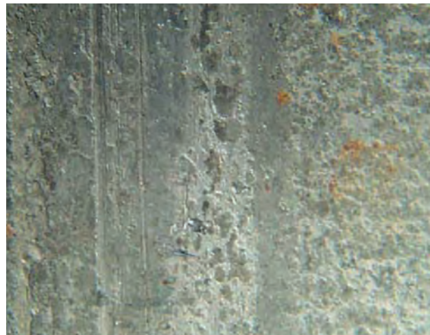
Fig. 1b Se puede apreciar claramente en el primer plano: el material del cojinete está corroído
