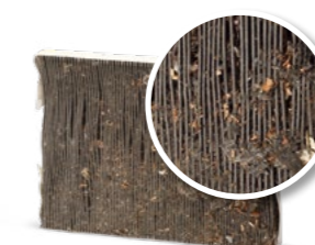
Senza manutenzione del sistema A/C
