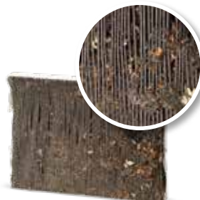
Brez vzdrževanja klimatske naprave
