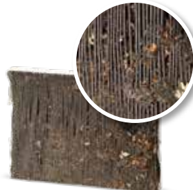
Sin mantenimiento de la climatización
