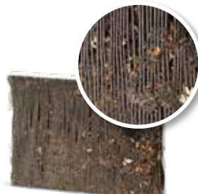
Brez vzdrževanja klimatske naprave
