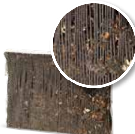
Fără întreținerea climatizării
