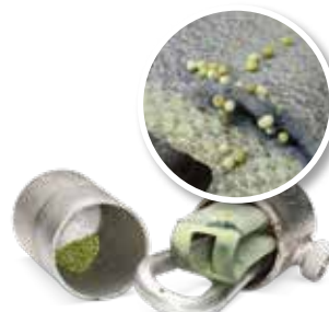
Sem manutenção do ar-condicionado
