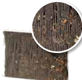
Brez vzdrževanja klimatske naprave
