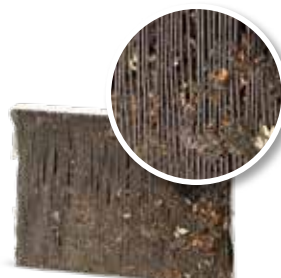
Fără întreținerea climatizării
