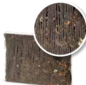
Χωρίς συντήρηση του συστήματος κλιματισμού
