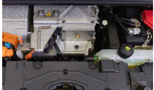
Componentes de alta tensión en el compartimento del motor
