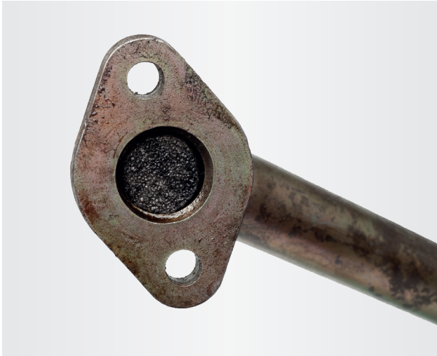
Resim 1 Koklaşmış yağ geri dönüş hattı
