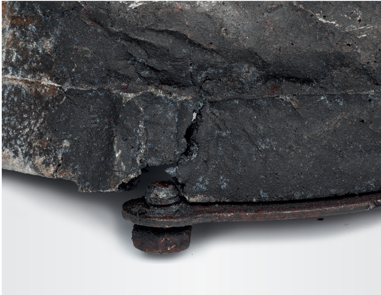
Fig. 1 Fisura en la carcasa de la turbina
