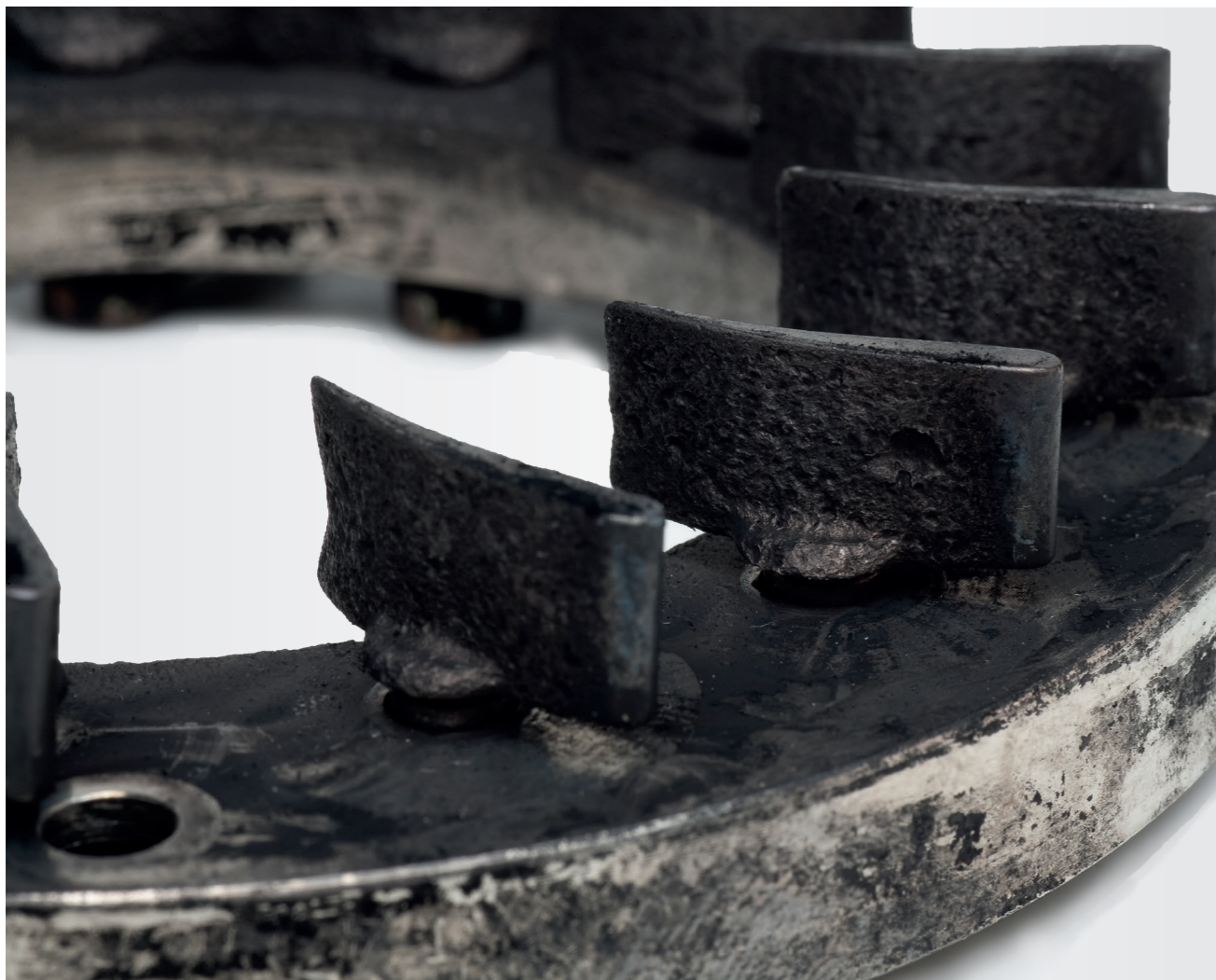
Fig. 1 Déflecteurs de l'unité TGV endommagés
